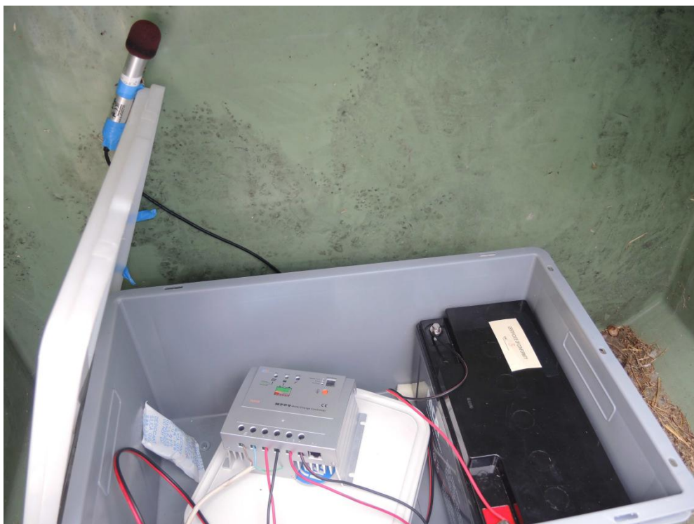
Figure n°2 : Détail de l'installation électrique avec à droite la batterie et à gauche la Beagleboard et le contrôleur de charge.
