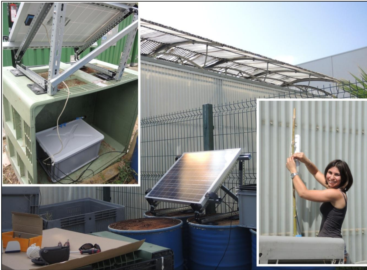
Figure 9 : Installation de la JASONbox sur le campus de l'Université de Toulon.
